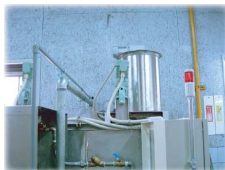
定量供給フィーダーにより、粉体凝集剤を自動的に定量供給します。
